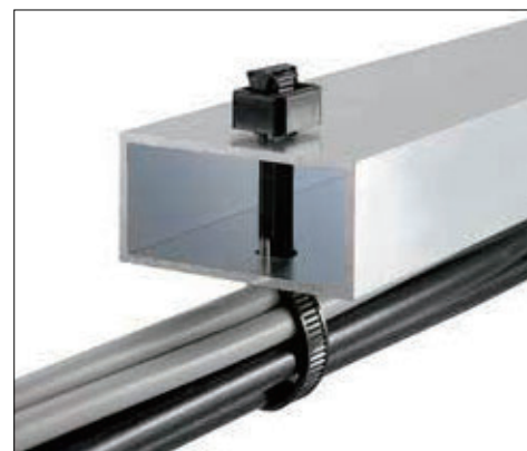
パネルから離して結束した例
